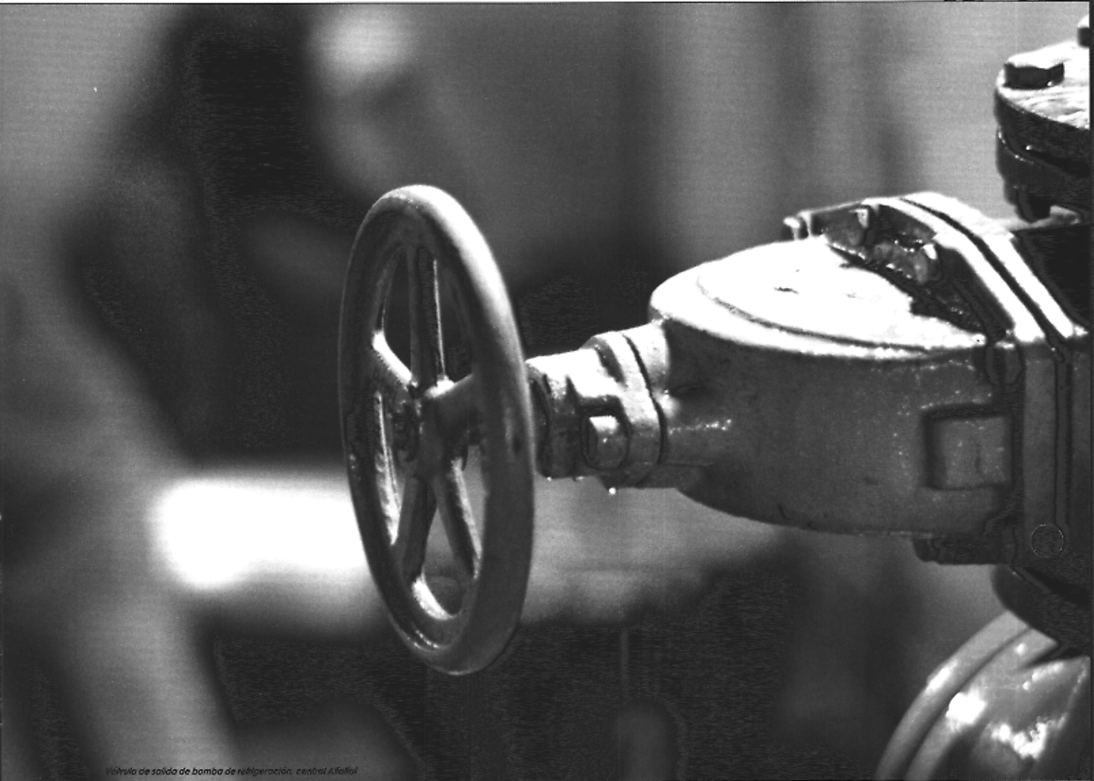
Válvula de salida de bomba de refrigeración, central Afloral
